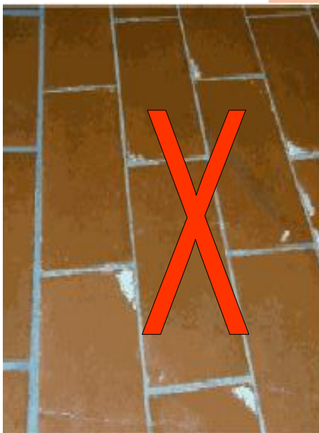
No Pisos agrietados
