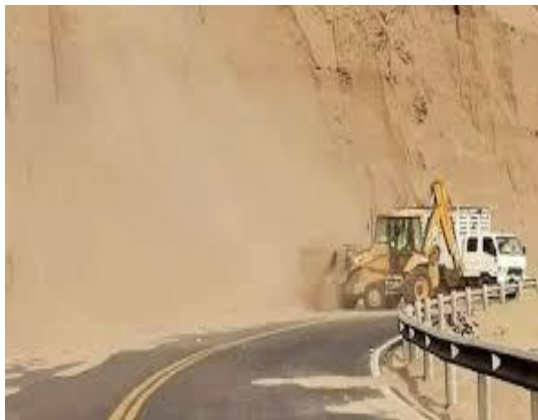
El peligroso serpentín de Pasamayo
