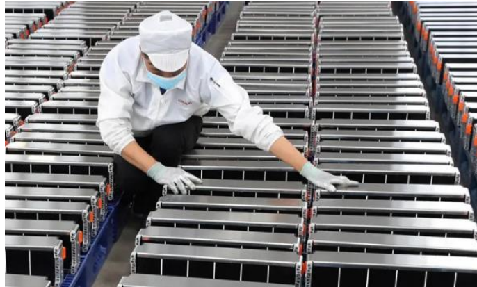
Figura 9 Baterías de litio
