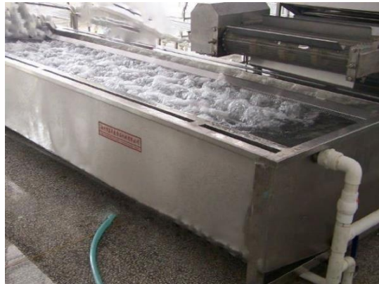
Duchas a presión y sistema de lavado por burbujeo
