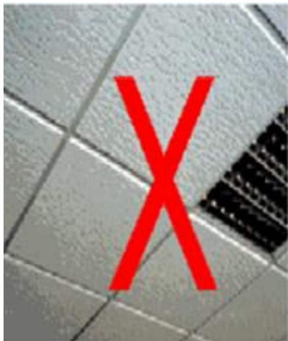
No falsos techos con aberturas
