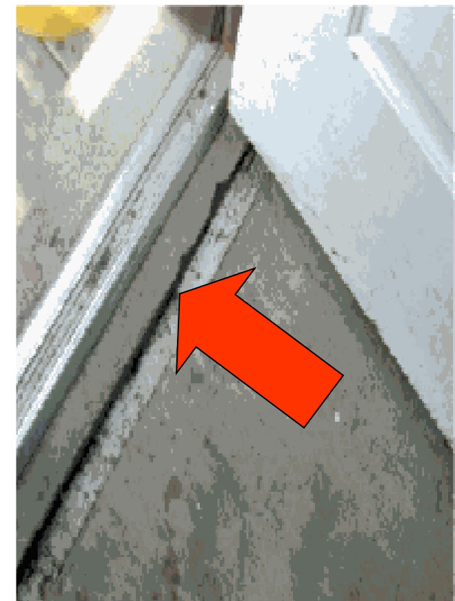
Uniones separadas deberían ser llenadas o selladas
